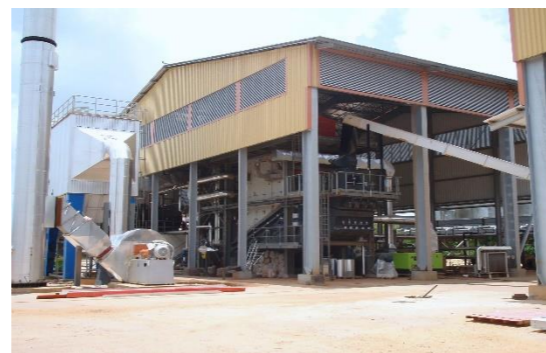
Centrale biomasse Kourou (Guyane)
